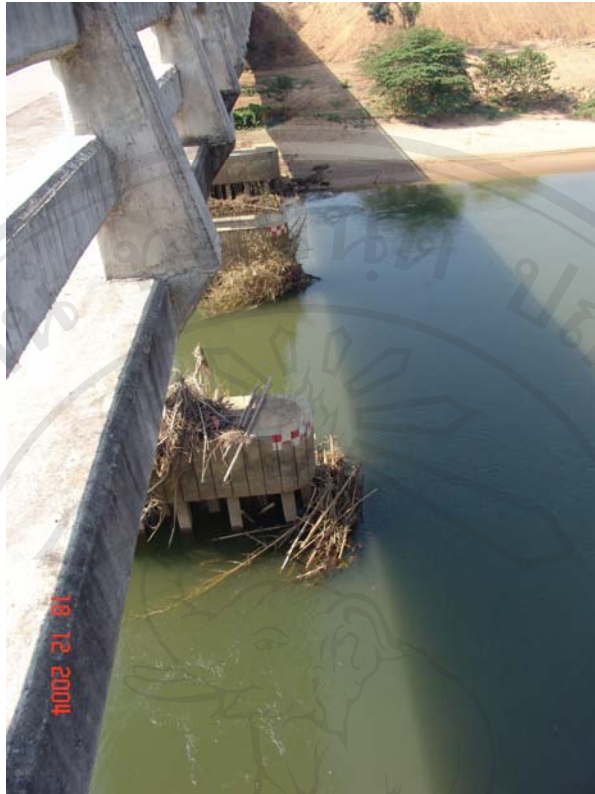
ภาพที่ 4.14 รูปแสดงเศษซากไม้ที่ถูกน้ำหลากน้ำท่วม พัดพามาติดที่บริเวณใต้สะพาน
