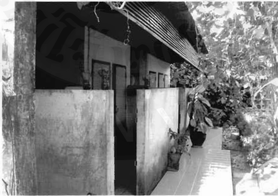
สภาพบริเวณห้องน้ำ
