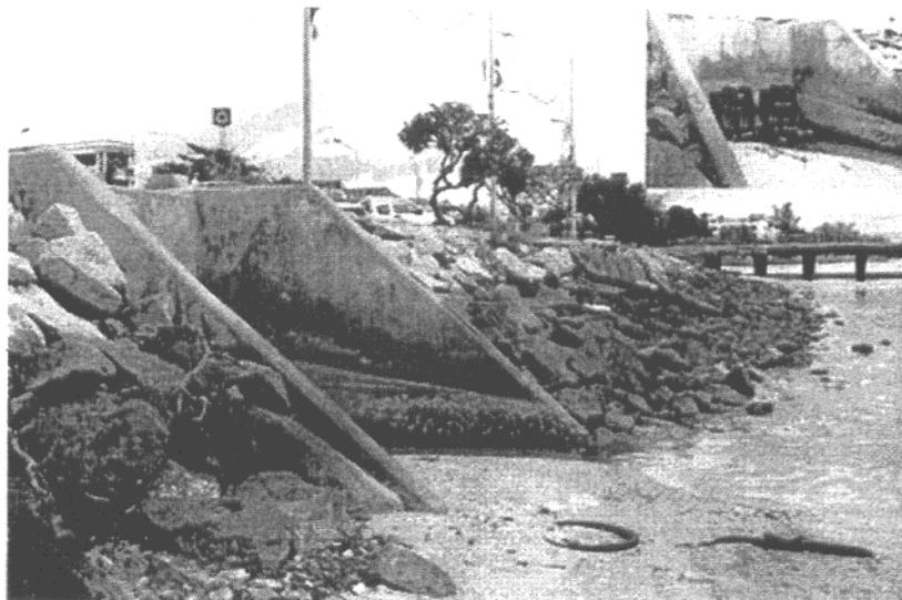
ภาพที่ 4.14 ประตูละบายน้ำริมเขื่อนบริเวณลานจอดรถ
