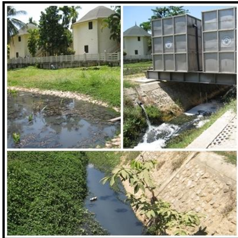
ภาพ 4.12 ระบบบำบัดน้ำเสียและน้ำเสียที่ผ่านการบำบัดแล้ว
