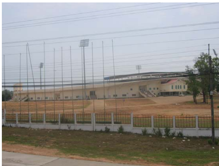
ภาพประกอบ 43 แสดงภาพสนามกีฬาแห่งชาติ แขวงสะหวันเขตที่กำลังก่อสร้างเพื่อรองรับ กิจกรรมทางกีฬา ที่มา:บันทึกเมื่อ 26 มีนาคม 2550
