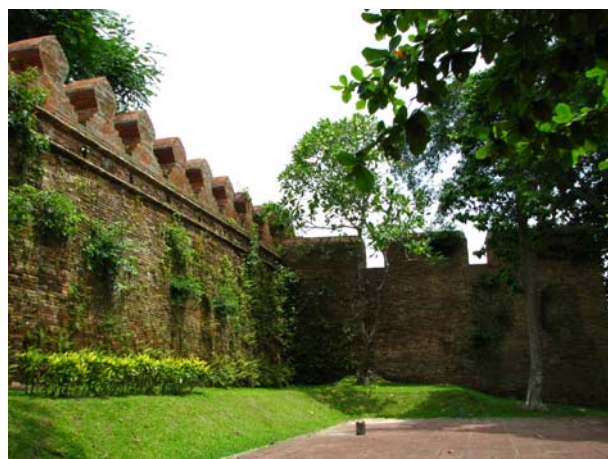
ภาพที่ 4.43 กำแพงเมืองนครศรีธรรมราช เป็นสถานที่ที่พระพุทธเจ้าหลวงเสด็จประพาสผ่าน ที่มา : จากการสำรวจเส้นทาง เมื่อวันที่ 20-21 พฤษภาคม, 2551.
