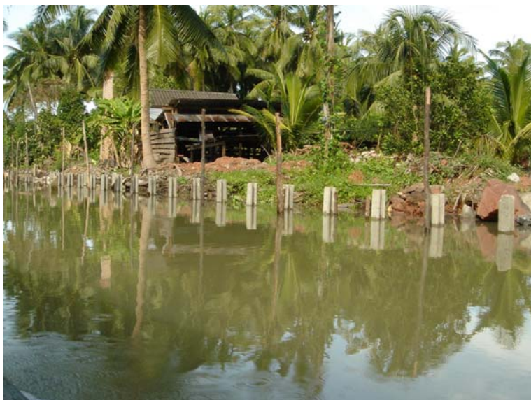
ภาพที่ 4.32 แสดงภาพรูปแบบเขื่อนเข้มน้ำที่ก่อกำล้งก่อสร้างเพิ่มเติมที่พบในพื้นที่
