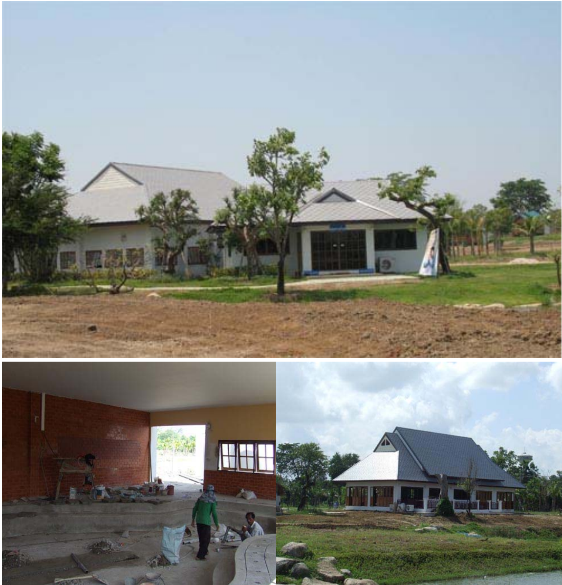
รูปที่ 6.12 อาคารแช่น้ำแร่และบริการนวดแผนไทยที่อยู่ในระหว่างการดำเนินการก่อสร้าง
